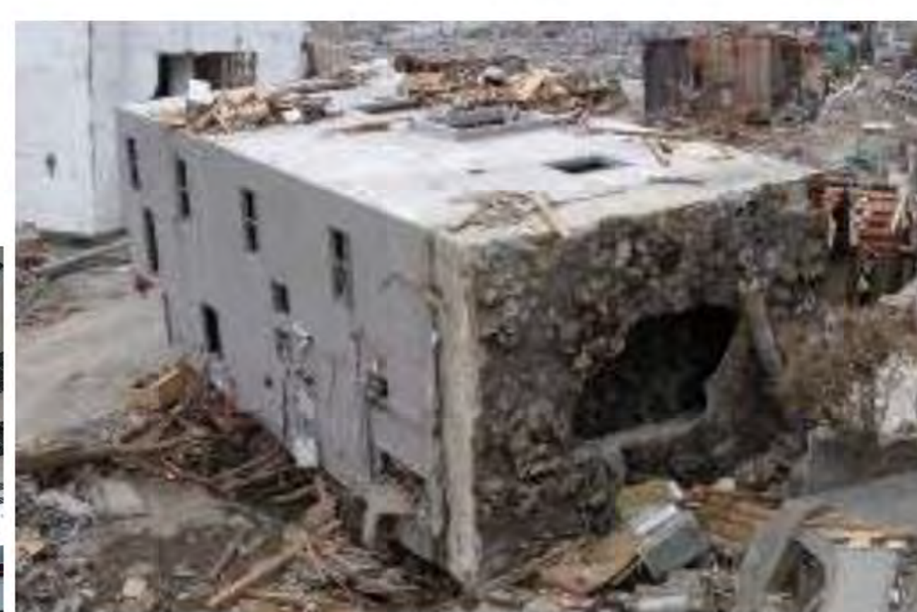
津波により流出した建物
