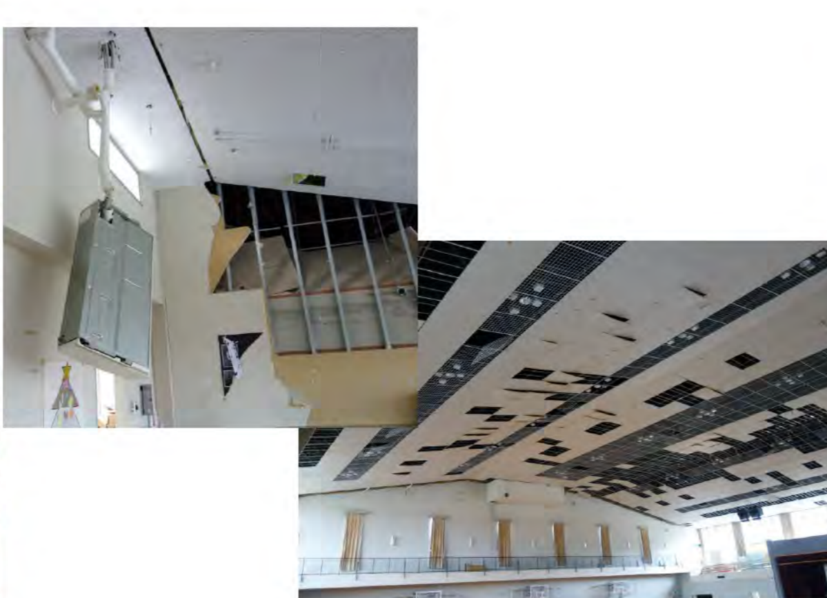
非構造物の被害
