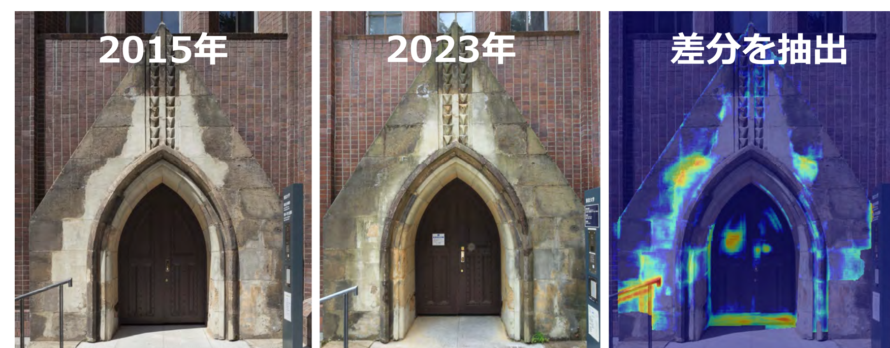
スマートフォンで撮影した写真を用いた差分検出 (東京大学 安田講堂 入口での劣化・損傷の発見)
