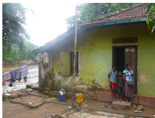
Kalu川沿いで浸水により被災した家屋の状況
