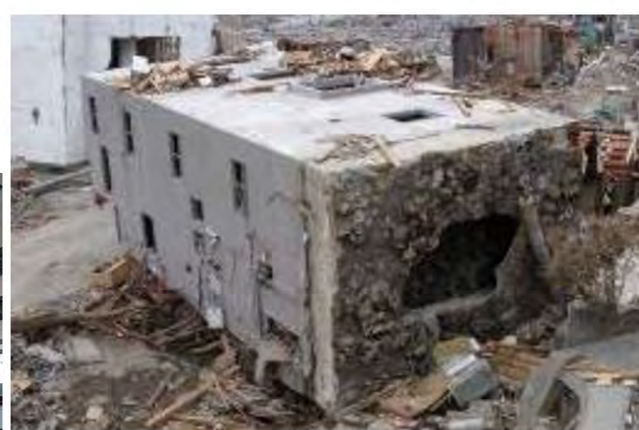
津波により流出した建物
