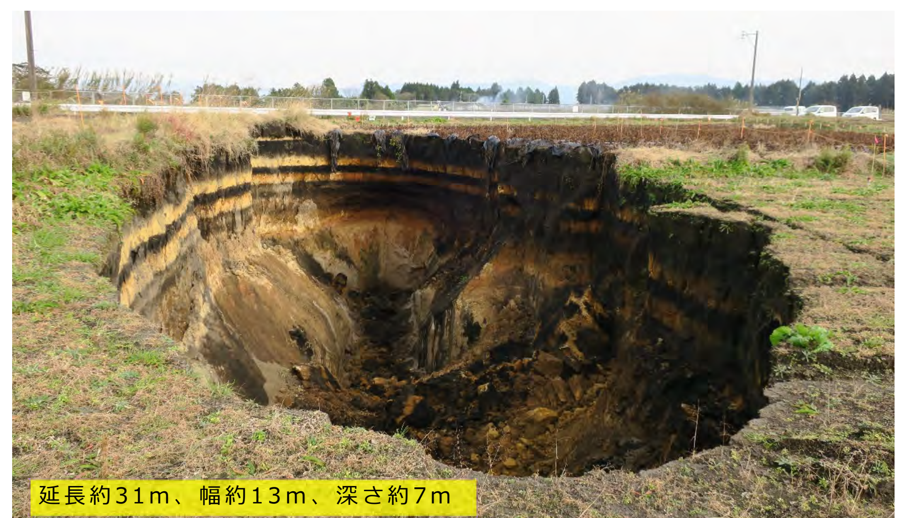
都城・宮崎県の畑で起きた、豪雨によるシラス層の内部侵食による陥没（2016年9月）
